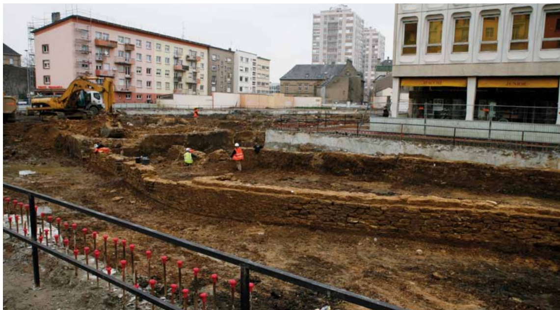
La Cour des Capucins: chantier suspendu à l'initiative de l'aménageur la société ALTAREA
