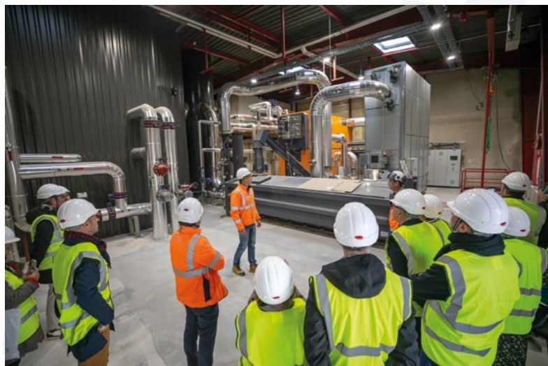
04.11.2025 Inauguration de la chaufferie biomasse Saint-Pierre
